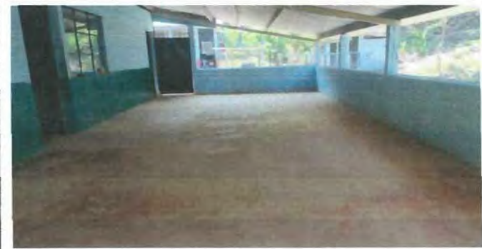
FOTO 4: Vista pasillo del establecimiento. El piso actualmente es de cemento y derivado del tiempo de colocación presenta notorio desgaste.
