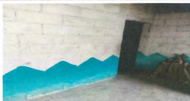
FOTO 8: Vista general de las paredes de la cocina del establecimiento, mismas que no se encuentran repelladas y presentan deterioro.
