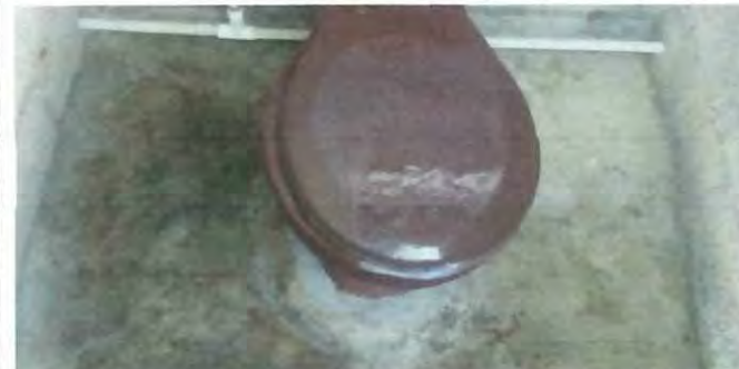
FOTO 10: Vista del piso de cemento de los sanitarios, presenta deterioro derivado del tiempo de su instalación.
